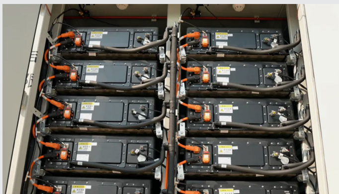
باتری‌های سدیم-یون مورد استفاده در ایستگاه ذخیره انرژی بائوچی
